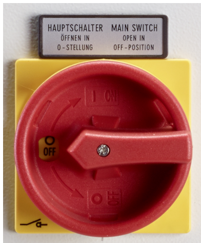
Fig. 2: Interrupteur électrique général
